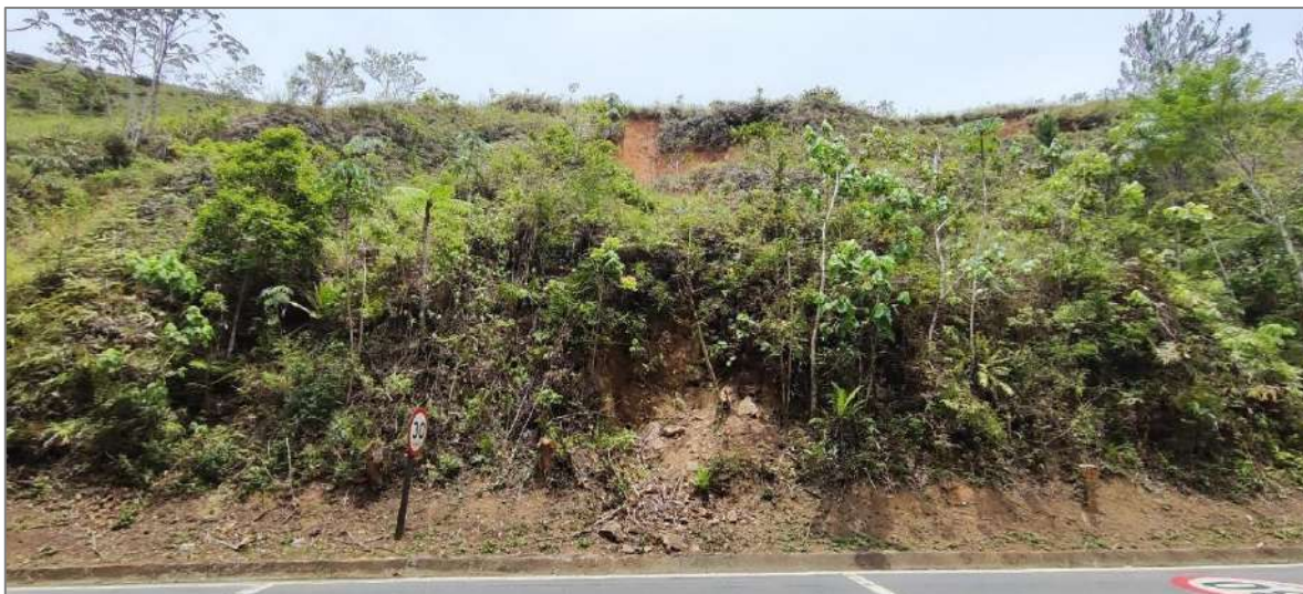
FIGURA 21 – EROSÃO DE GRAU ALTO LOCALIZADO NA RODOVIA SP-050 – BAIRRO PONTE NOVA FONTE: ELABORADO PELO AUTOR, 2025
