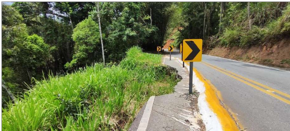
FIGURA 20 – PONTO DE EROSÃO 4 – VISTA 2, DANIFICOU PARTE DA RODOVIA SP-050. FONTE: ELABORADO PELO AUTOR, 2025
