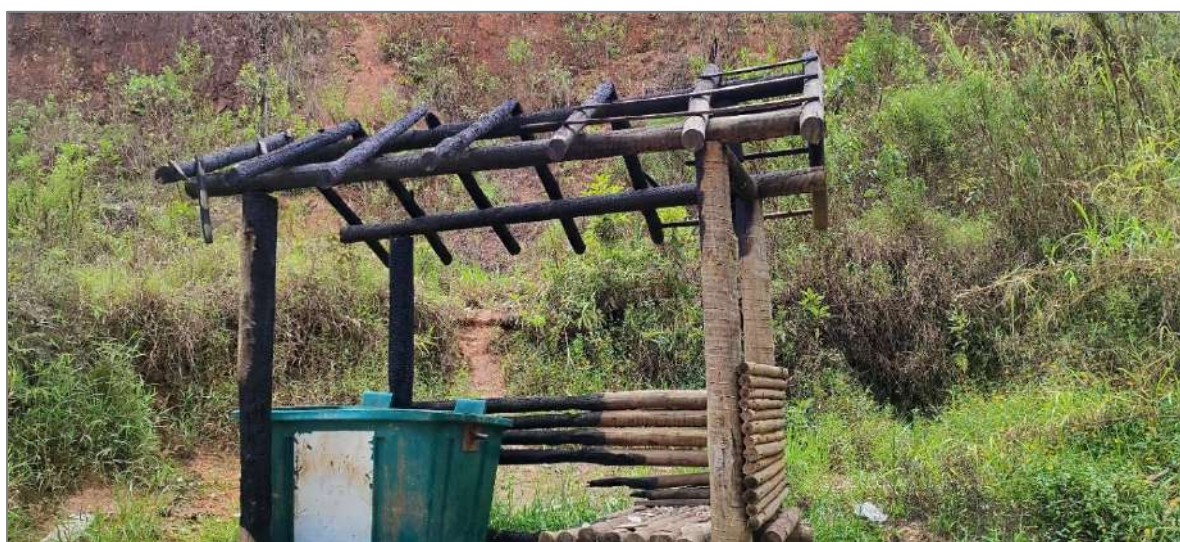
FIGURA 26 – INCÊNDIO CAUSOU DANOS À LIXEIRA QUE FICA PRÓXIMA AO PONTO DE OCORRÊNCIA.
