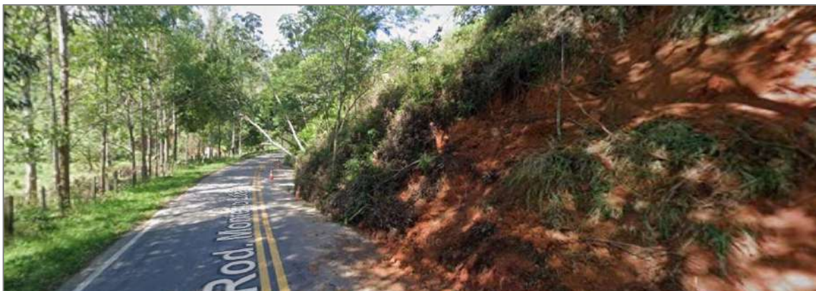
FIGURA 22 – IMAGEM DA EROSÃO NO ANO DE 2024 ANTES DA OBRA DE CONTENÇÃO.
